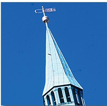
Abb. 3.5 Bildfehler im Dach der Kirche
