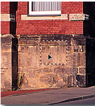
Abb. 4.47 Die Kanten sind sichtbar
